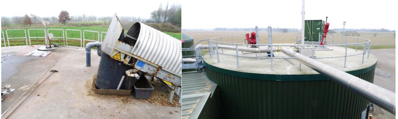
Abbildung 11: Aspekte zweier beispielhaft ausgewählter Hydrolyse- und Versäuerungsstufen mit nicht gasdichter (links) und gasdichter (rechts) Abdeckung (Fotos: Cordes+Winterberg)
